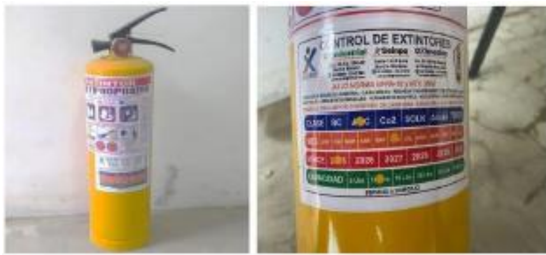
Extintor vigente hasta junio de 2025.
