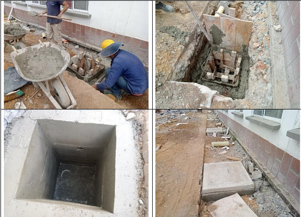
Cajas de recoleccion e inspeccion sanitarias
