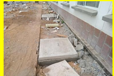
CAJAS DE INSPECCION ALCANTARILLADO SANITARIO
