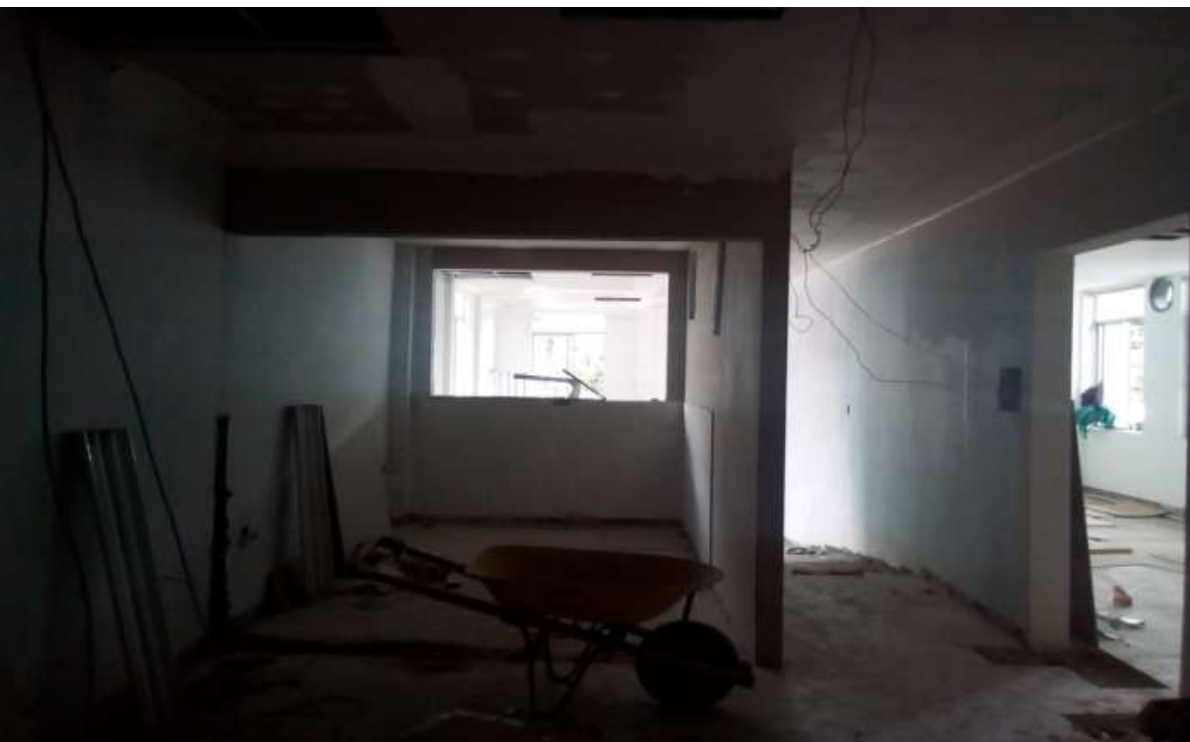
LABORATORIO DE PATOLOGÍA - ANTES
